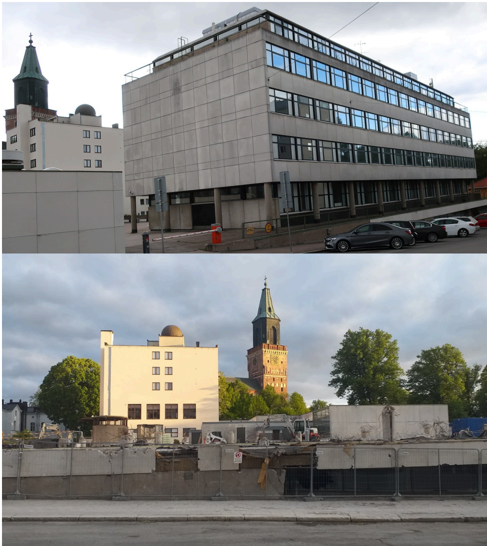
Kuva 14. Ylempi kuva: Gadolinia vuonna 2021. Alempi kuva: Gadolinia kesällä 2023, kun lähes koko rakennus on jo purettu. Uusi rakennus rakennetaan vanhan Gadolinian kellarin ja alimman kerroksen päälle.
